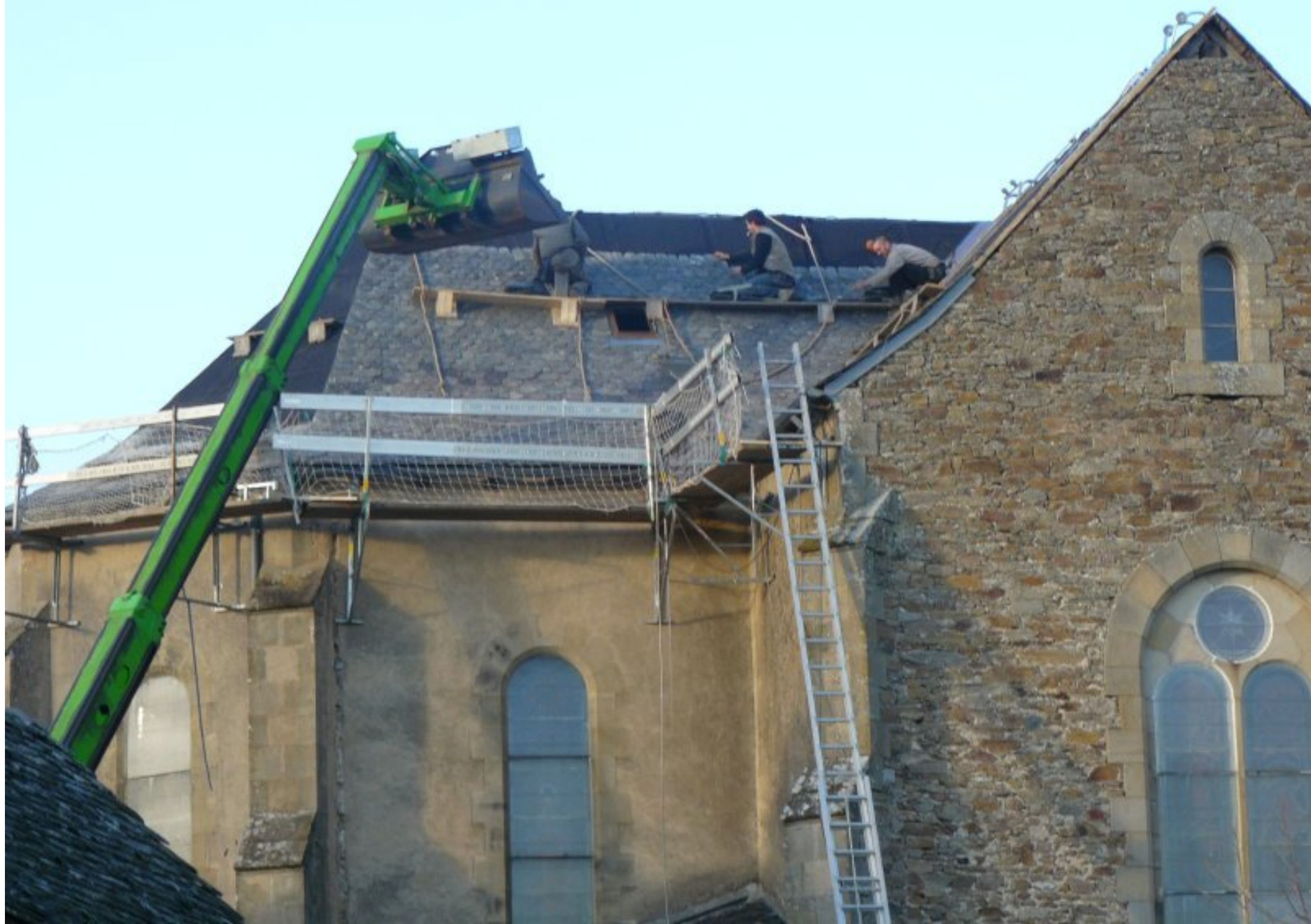
L'équipe des couvreurs de Didier Bounhol (St. Martin des Faux) en pleine action sur le toit de l'église de Meljac - 17 janvier 2011
